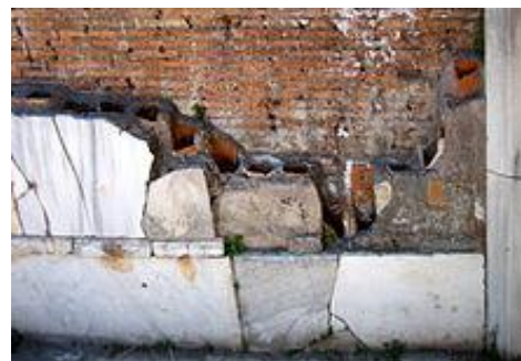
Tubuli in ceramica nelle pareti
